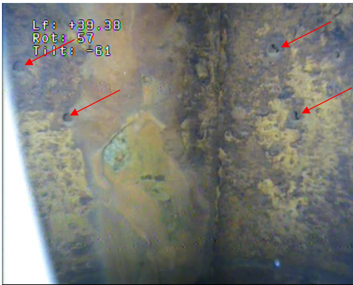
31 – Bas du premier niveau de crépine
