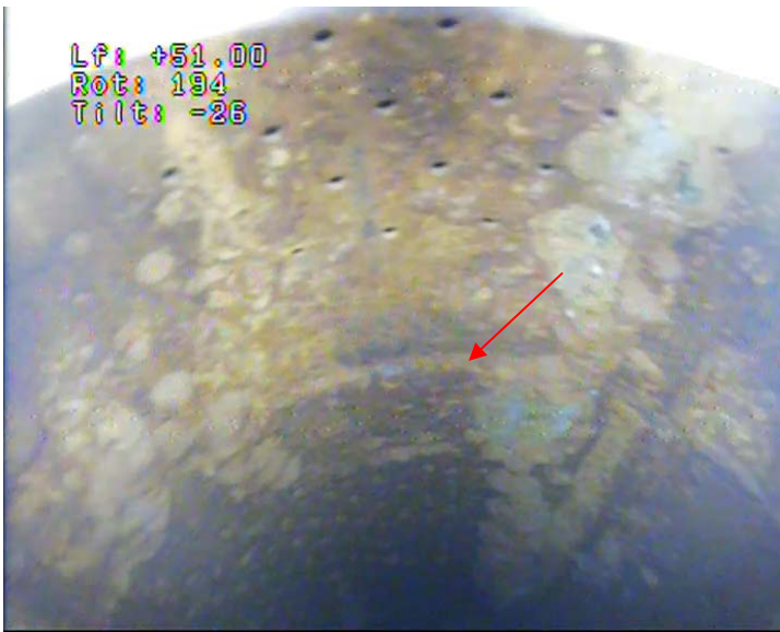
43 – Crépines bien ouvertes, soudure n°32
