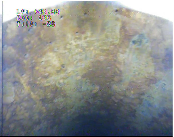
42 – Crépines partiellement colmatées
