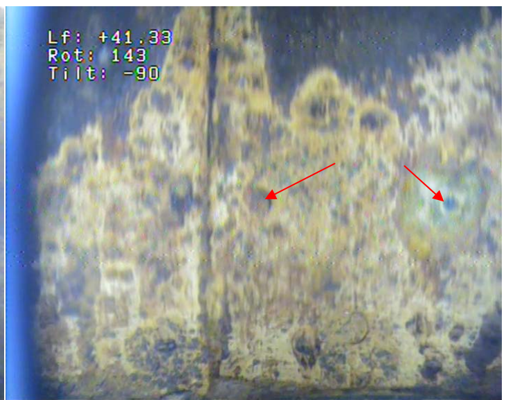
34 – Tubage acier en Ø 500 mm, soudure n°27, avec une rangée de trous environ 10 cm au dessus de la soudure
