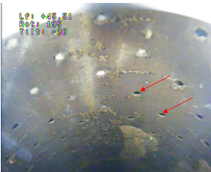
39 – Crépines bien ouvertes (sans massif filtrant visible)
