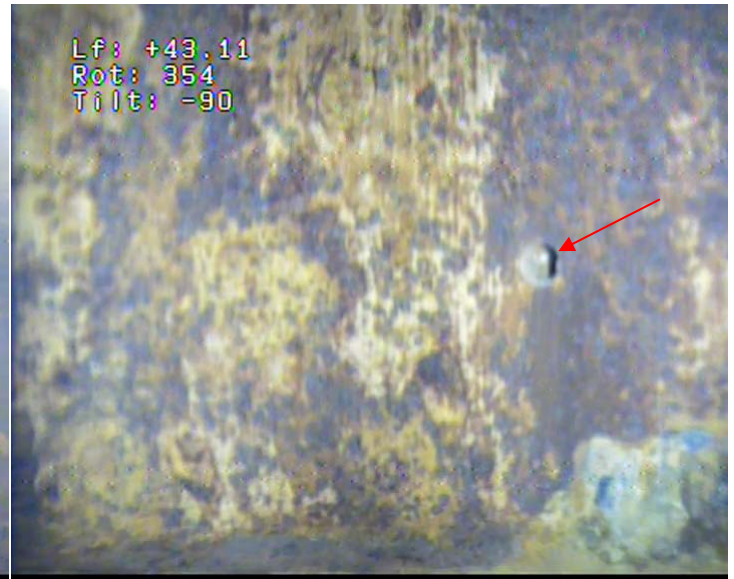
36 – Tubage acier en Ø 500 mm, soudure n°27, avec une rangée de trous environ 10 cm au dessus de la soudure
