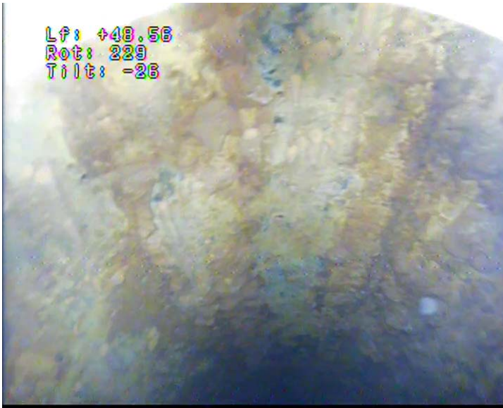
41 – Crépines partiellement colmatées
