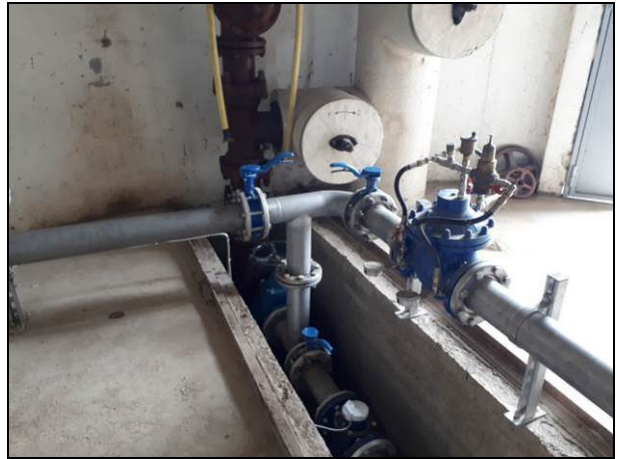
Photo 6 : Refoulement du captage et caniveau technique
