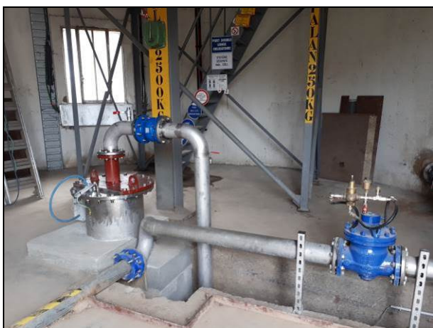
Photo 3 : Tête de puits
