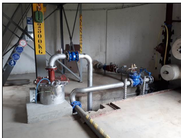
Photo 2 : Tête de puits
