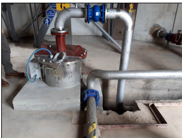
Photo 1 : Tête de puits
