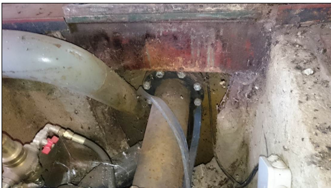
Figure 6 : Vue de la tête de puits
